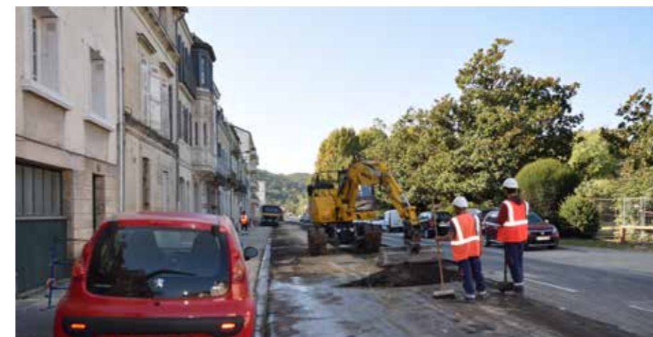
D'importants chantiers ont avancé en 2021 comme la réhabilitation de la station de Marsaneix, la création du réseau et d'une station à Antonne, la réhabilitation du réseau de la RD5E2 à Boulazac Isle Manoïre, la fin des travaux sur le secteur Mérillier à Coulounieix-Chamiers, le démarrage des travaux sur la station de Saltgourde à Marsac sur l'Isle...
