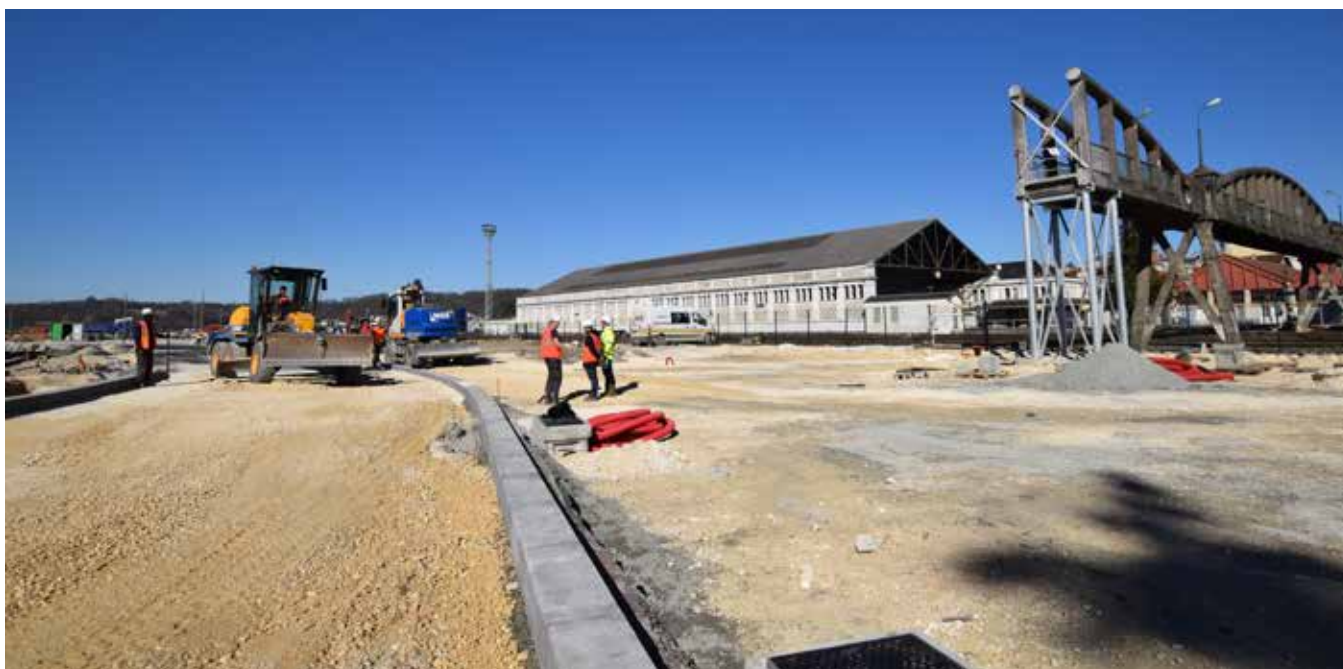
Dans le cadre du Pôle d'Echange Multimodal (PEM) de la gare de Périgueux, d'importants travaux ont été préparés en 2018 et effectués au cours du 1 er trimestre 2019, dont la démolition d'une arche de la passerelle de la gare SNCF de Périgueux et les aménagements au pied de cette passerelle.
